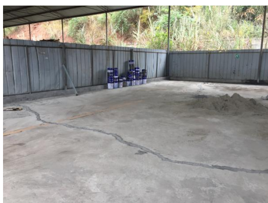
总部机关及一分厂危废暂存间
