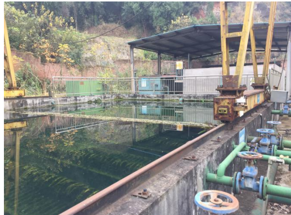
二分厂及配件厂大件区污水处理站
