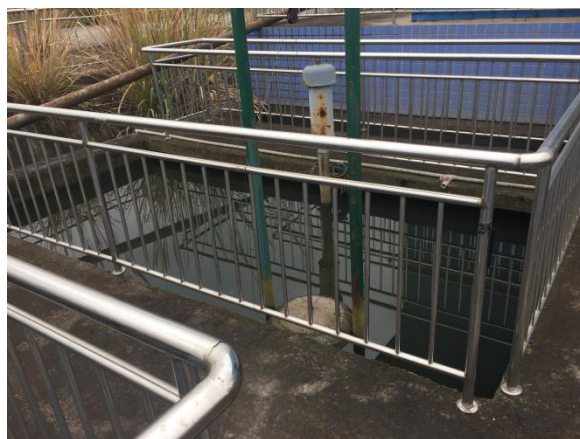
总部机关及一分厂污水处理站
