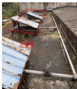
地下储罐（总部及高速机事业部油库）
