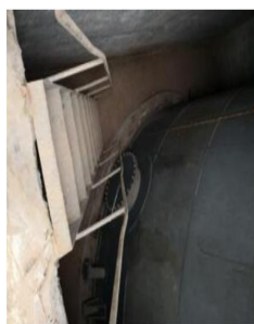
接地储罐（中速机事业部柴油库）
