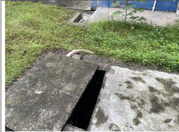
废水池内潜水泵
