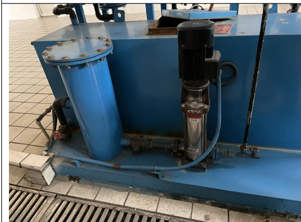
废气处理设施增压泵
