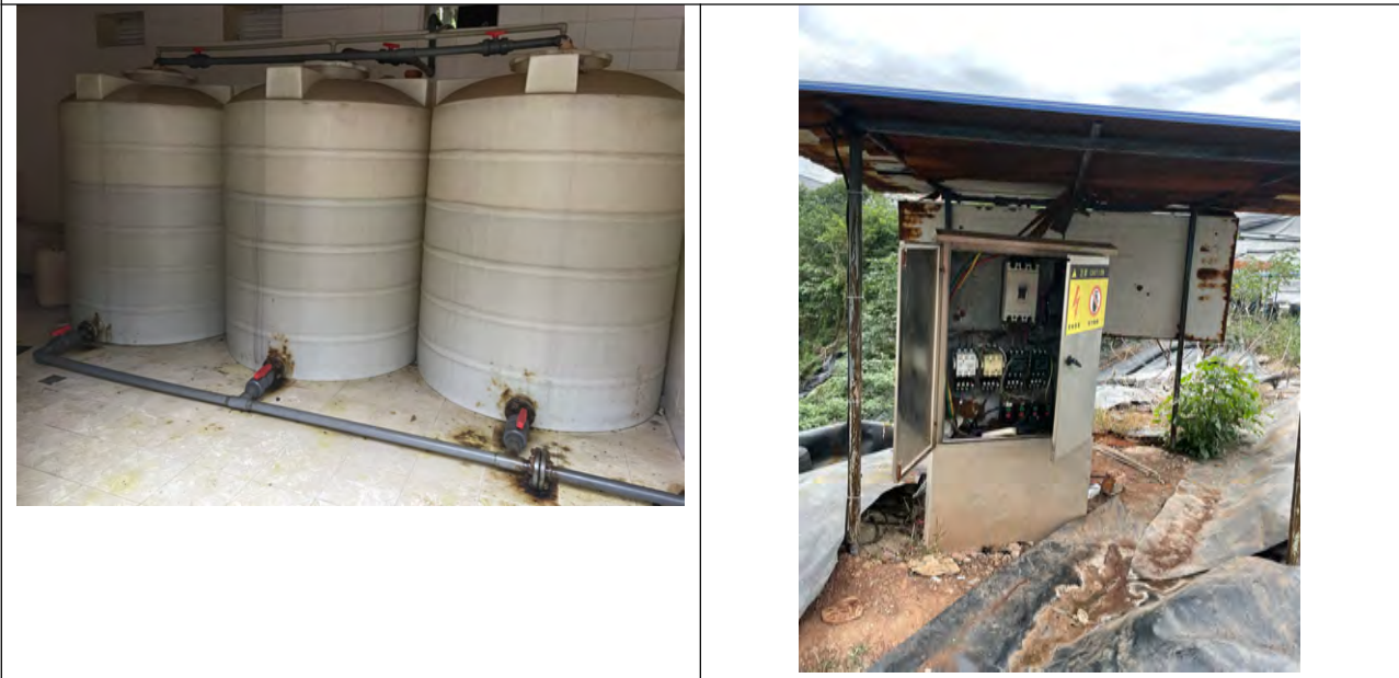
盐酸装载管道
