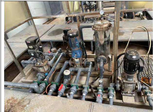
应急全膜化可移动渗滤液处置系统中各设备、管线
