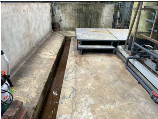
应急全膜化可移动渗滤液处置系统四周设置的雨水沟渠
