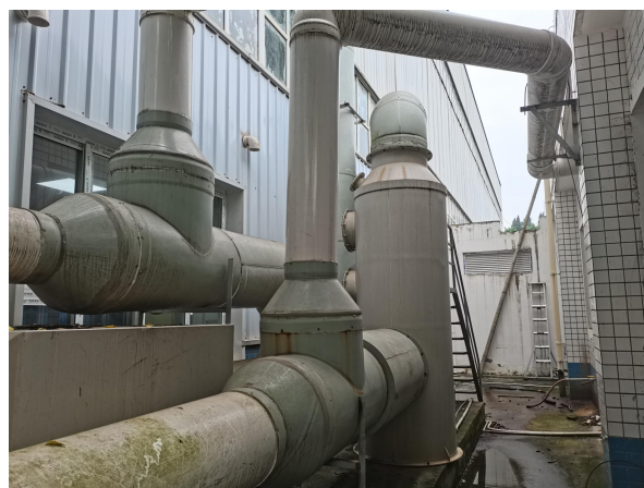
废气处理设施
