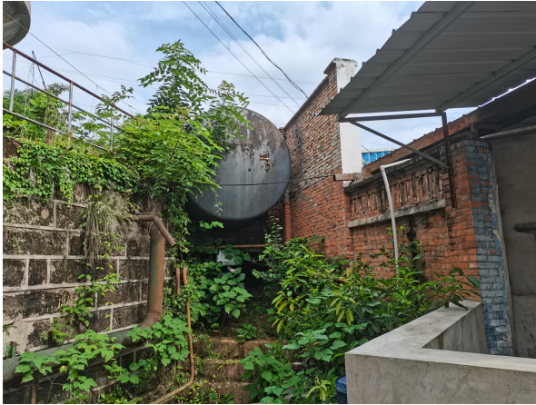
柴油罐（离地储罐）
