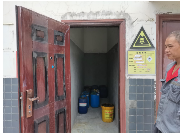
污水处理站内危废间
