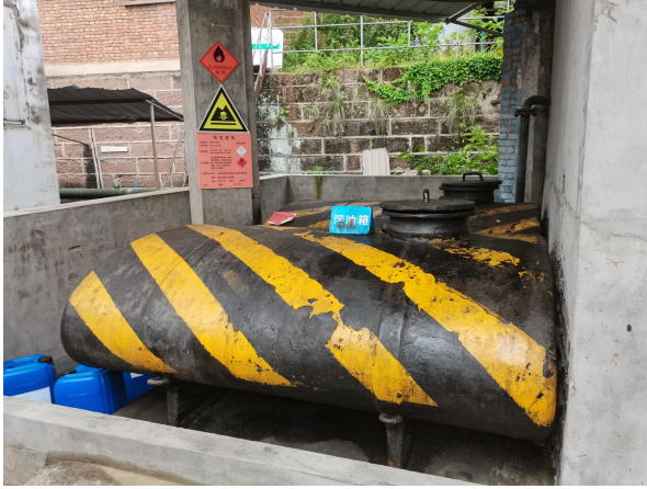
机车事业部废油罐（离地储罐）
