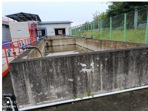
集团总部污水处理池
