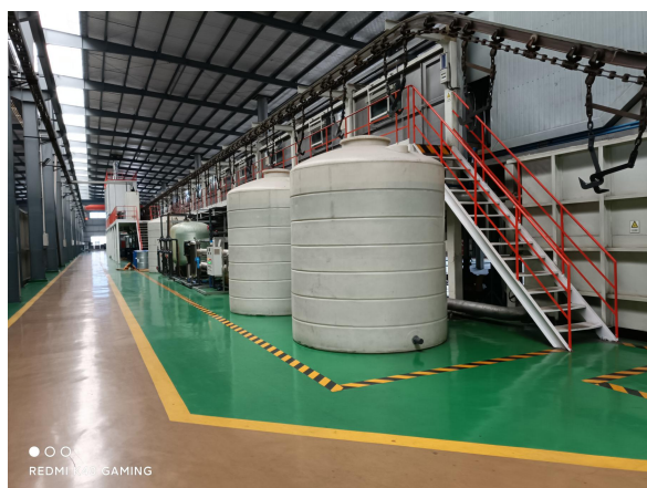
涂装车间（电泳线）
