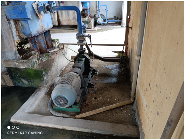
集团总部脱泥间传输泵
