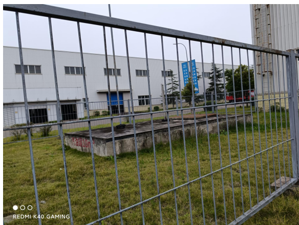
集团总部地下汽油储罐
