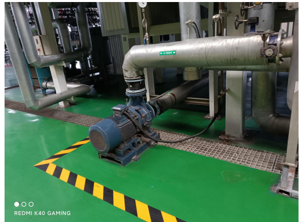
集团总部涂装电泳区传输泵
