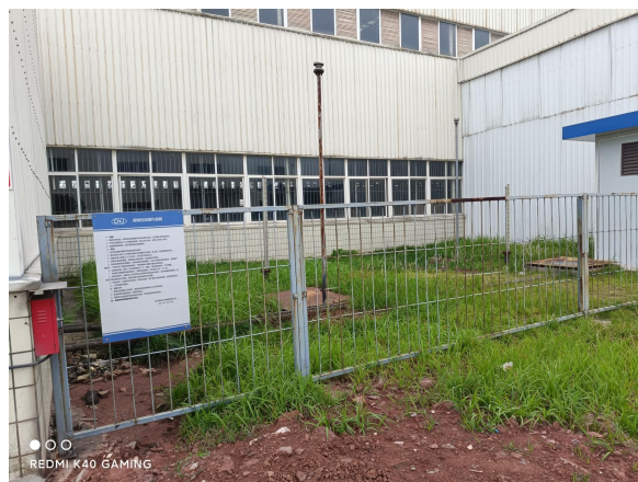
零部件产业园汽油和柴油储罐
