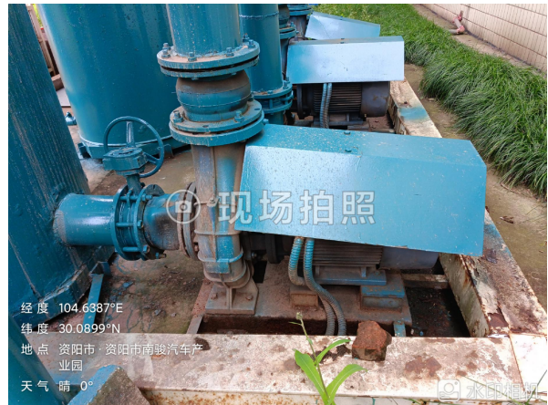
零部件产业园废水暂存池传输泵
