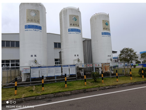
集团总部液化气体储罐
