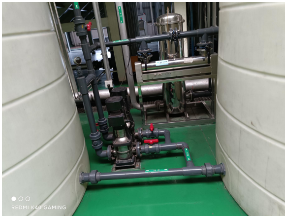
集团总部涂装电泳区传输泵
