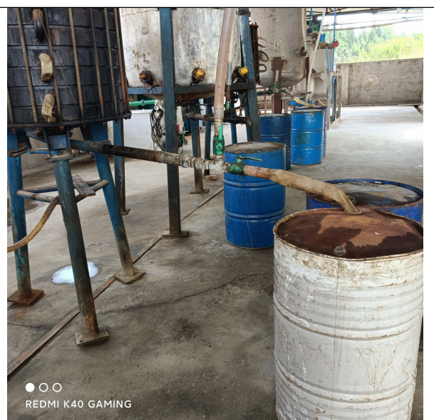
提纯车间（地面裂缝）
