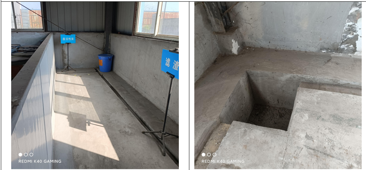
危废暂存间导流沟
