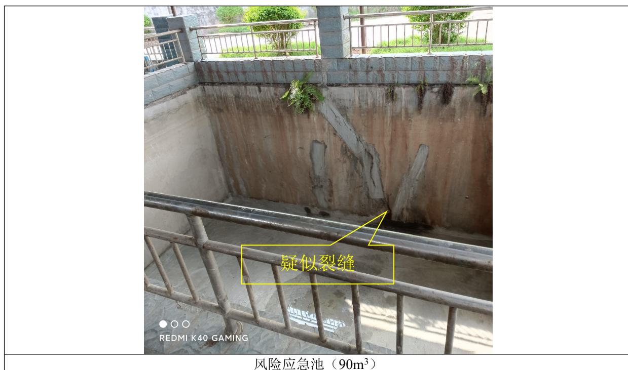
图 4.1-4 现场照片（应急收集设施）
