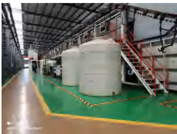
涂装车间（电泳线）
