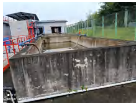
集团总部污水处理站
