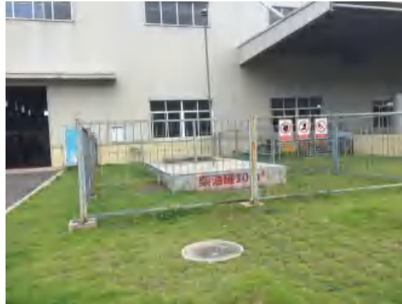
集团总部地下柴油储罐
