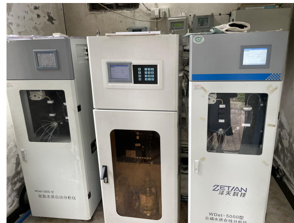
污水处理站（在线监测）
