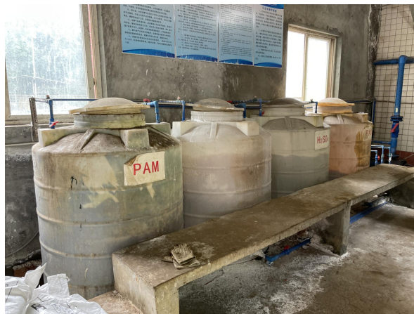
污水处理站（加药间）
