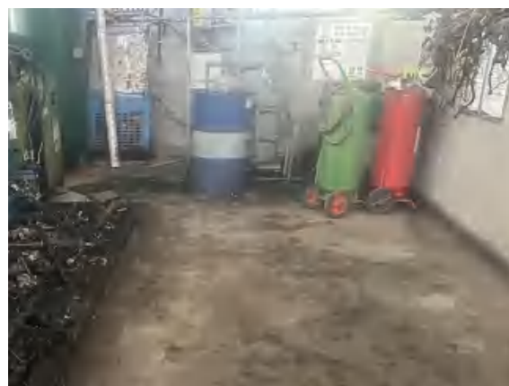
油水分离器、废油收集池、储油池区域（含油部件拆解区）
