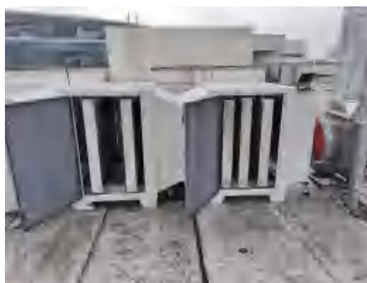
活性炭箱内部
