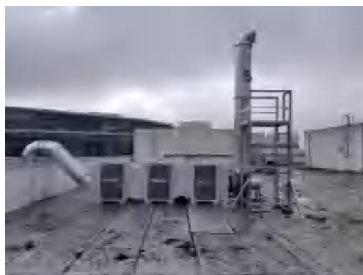
废气处理设施+排气筒
