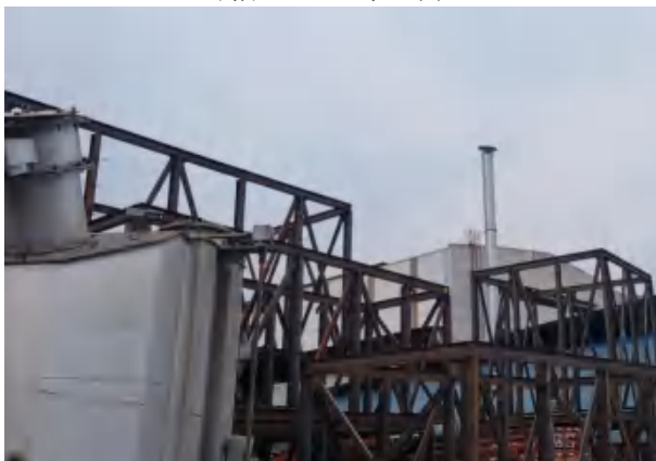
废气排气筒（2024 年 8 月）
