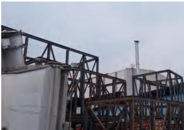
废气排气筒（2024 年 8 月）
