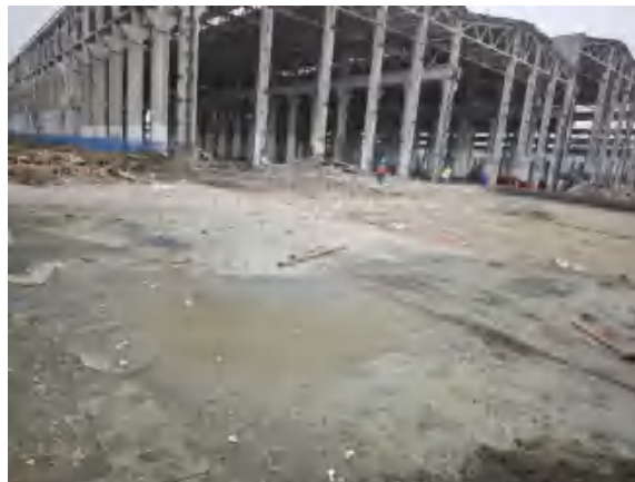
危废暂存间（2025 年 1 月）
