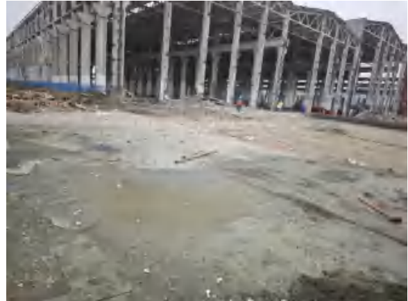
危废暂存间（2024 年 12 月）
