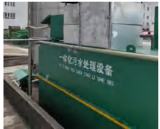
一体化污水处理设施
