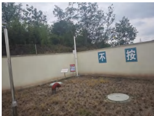
事故油池及警示牌
