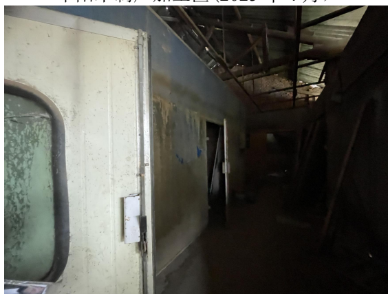
华阳木制厂喷漆房(2025 年 4 月)
