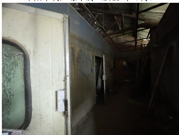
华阳木制厂喷漆房（2025 年 4 月）
