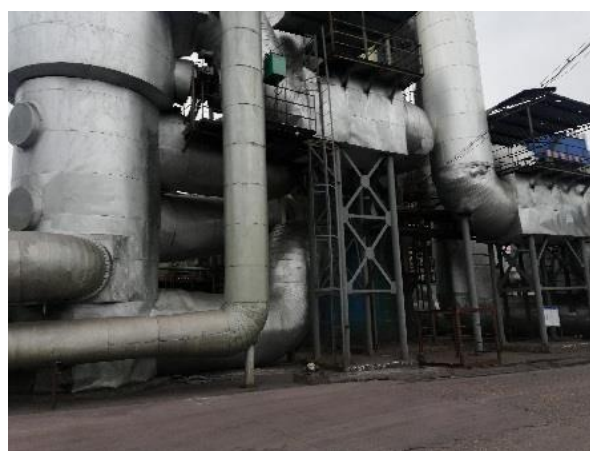
硫酸成品储存区
