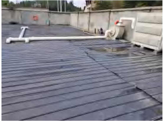
密闭收集+活性炭吸附装置
