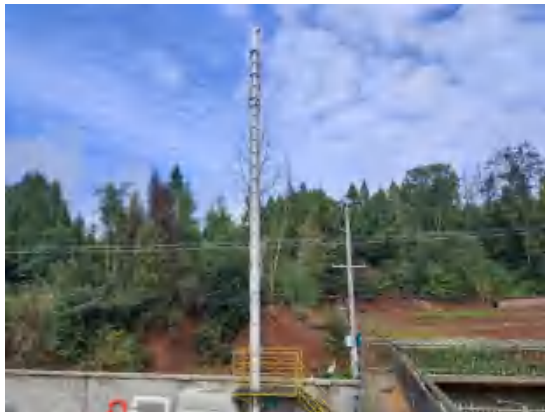
恶臭废气排气筒
