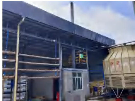
锅炉废气排气筒
