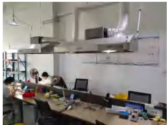
有机废气收集设施
